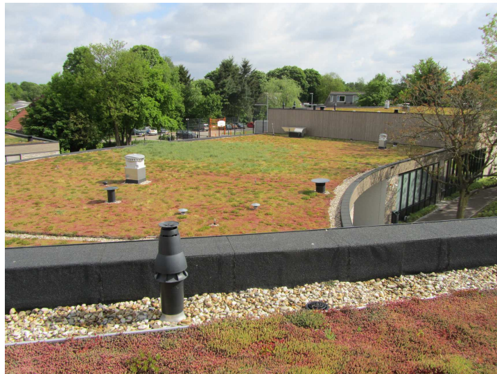
HUB Noord-Brabant. Veel waterberging in de drainagelaag én een gereguleerde dakafvoer.
