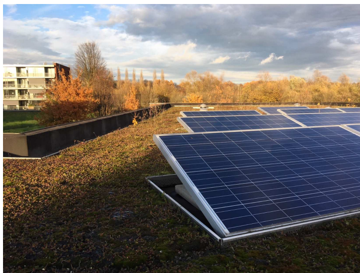
Combinatie groendak en zonnepanelen op het Milieueducatielokaal van BBS Nieuw Zuid
